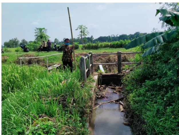
Gambar 1. Kondisi Pipa Pralon (Talang) Irigasi DI Ngarum
