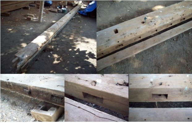
Gambar 8. Kondisi kerusakan kayu Sumber : Indrasana,2016
