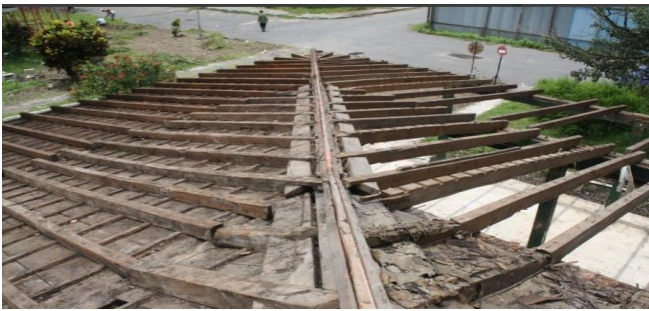
Gambar 5. Jenis Kerusakan Material Kayu Sumber : Indrasana, 2016
