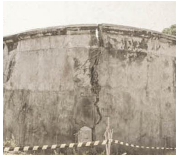
Gambar 10. Kerusakan pada BCB kolonial Sumber : cv. Djong Indonesia, 2019
