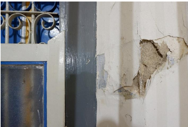
Gambar 6. Jenis Kerusakan pada BCB Bangunan kolonial
