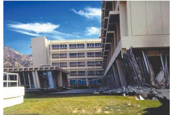
Gambar 1 Kegagalan struktur kolom bangunan di California akibat gempa Sumber: pubs.usgs.gov
