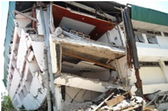
Gambar 4 Gedung Kantor Pemerintah Yang Runtuh Akibat Gempa Sumber: Iffah
