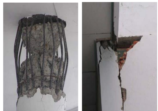
Gambar 3 Kegagalan elemen dan sambungan struktur Sumber: Pribadi
