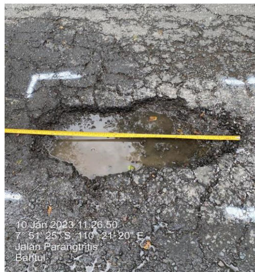
Gambar 11. Contoh kerusakan jenis lubang ( pothole )
