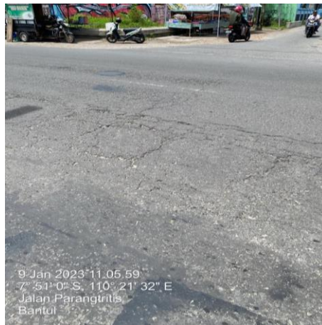
Gambar 8. Contoh kerusakan jenis retak blok ( block cracking )
