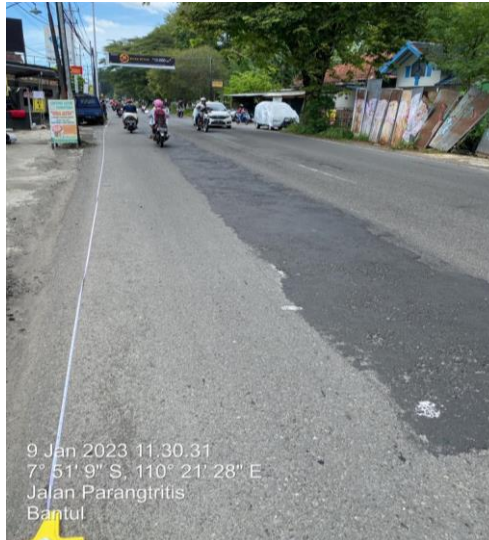
Gambar 10. Contoh kerusakan jenis tambalan ( patching )
