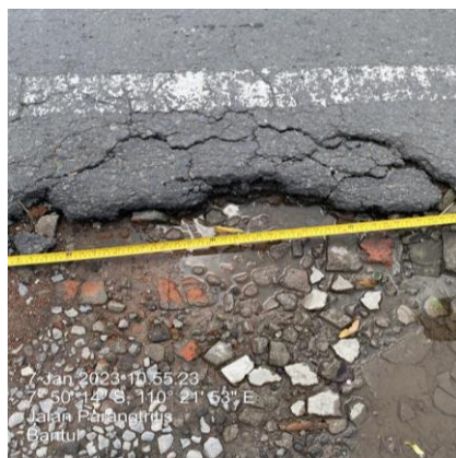
Gambar 9. Contoh kerusakan jenis retak pinggir ( edge cracking )
