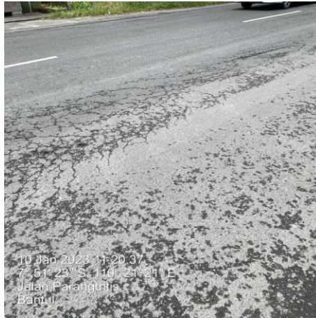
Gambar 7. Contoh kerusakan jenis retak buaya ( alligator cracking )
