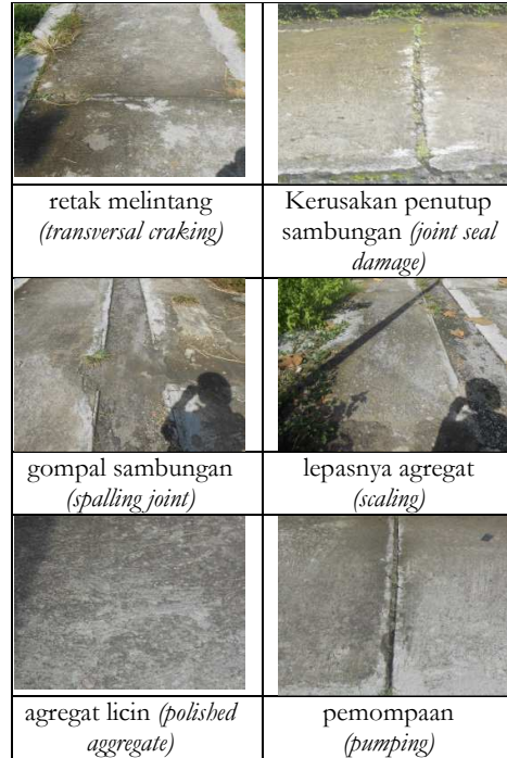
Gambar 4. Tipe kerusakan jalan yang terjadi
