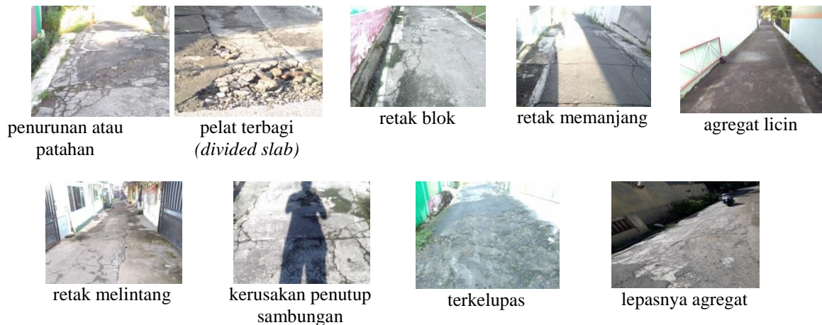
Gambar (d). Tipe kerusakan jalan beton yang terjadi
