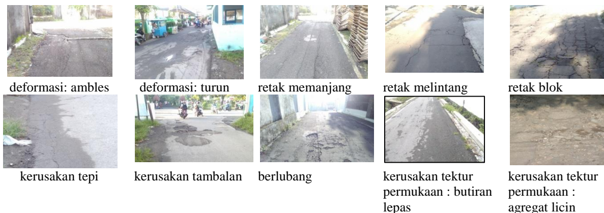
Gambar (e). Tipe kerusakan jalan aspal yang terjadi
