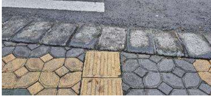
Gambar 9. Blok pengarah terputus dan tidak ada blok peringatan Sumber: Observasi Lapangan (2023)
