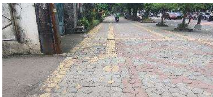
Gambar 8. Blok pengarah terputus Sumber: Observasi Lapangan (2023)
