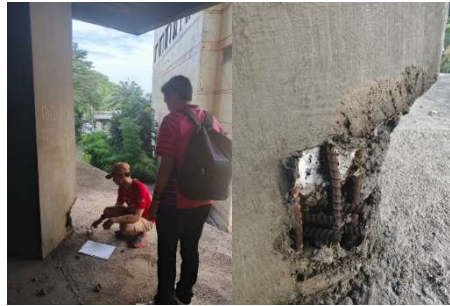
Gambar 4. Kondisi Degradasi Elemen Kolom
