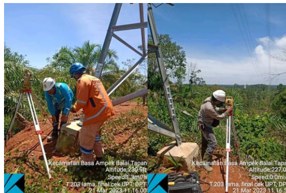
Gambar 1. Lokasi Tower TW. 203, GI Kambang – GI Tapan
