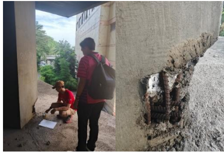
Gambar 4. Kondisi Degradasi Elemen Kolom
