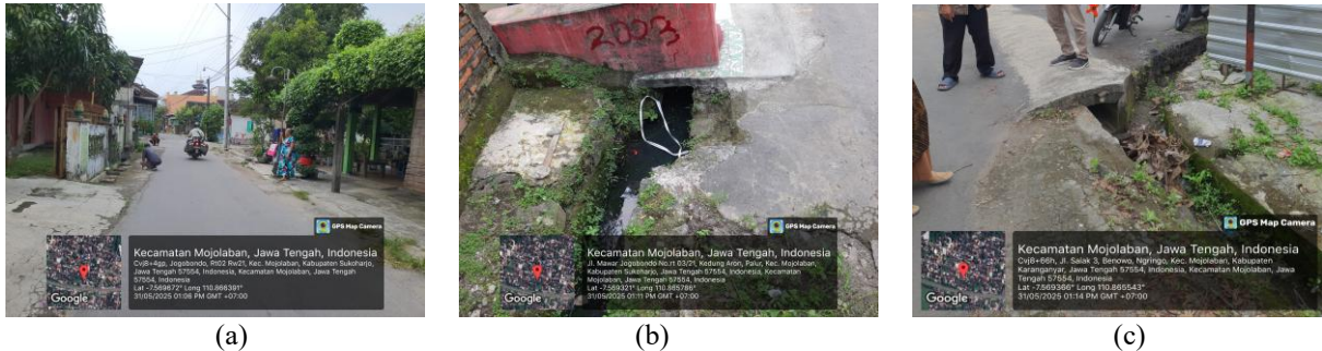
Gambar 1. Kondisi awal saluran drainase lingkungan di Dukuh Jogobondo: (a) kondisi jalan lingkungan lokasi kegiatan, (b) bukaan saluran pada akses masuk rumah warga, dan (c) saluran eksisting yang mengalami endapan, sampah, dan pertumbuhan vegetasi.
